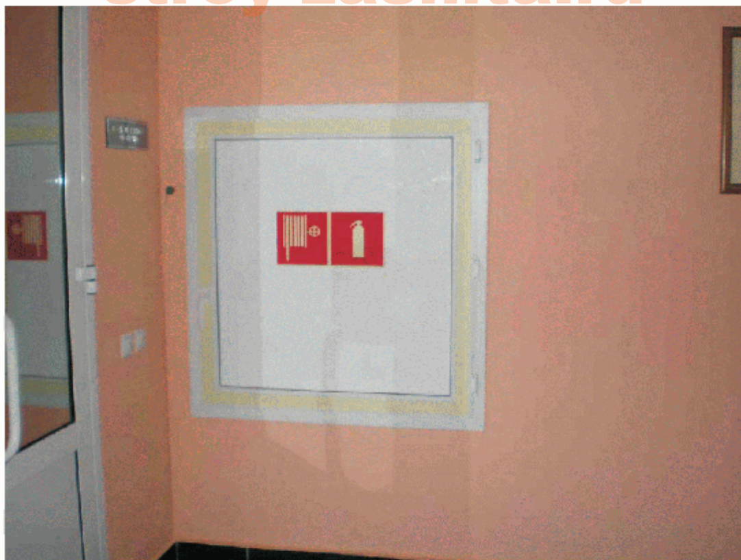
Рисунок А.6 — Обозначение фотолюминесцентной 50-мм лентой контура пожарного оборудования и использование знаков пожарной безопасности
